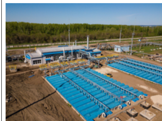
Новые объекты очистных сооружений
