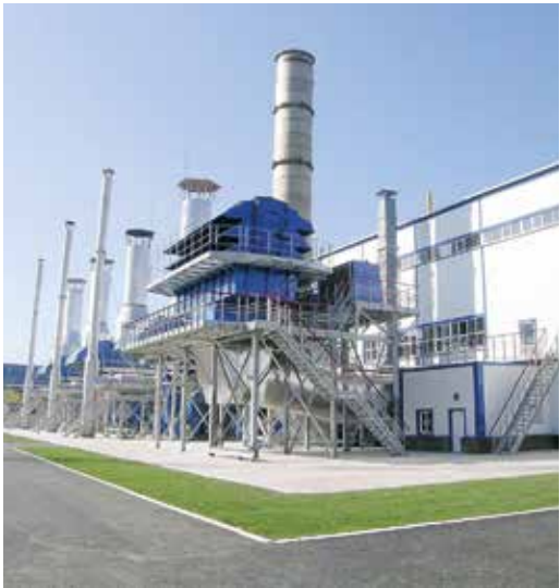
КС-18А «Москово» после реконструкции
